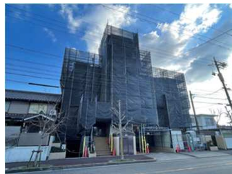
令和7年度にマンション管理組合から工事監理を受託した物件
